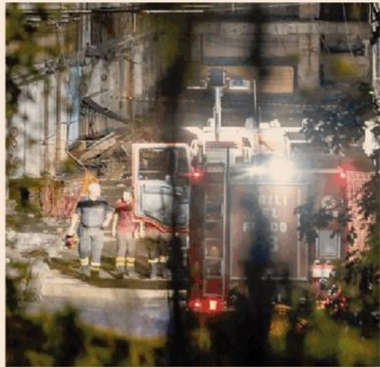
Il ballatoio. Il crollo è avvenuto nella notte di lunedì
